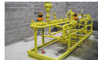
Poste d'injection réseau
