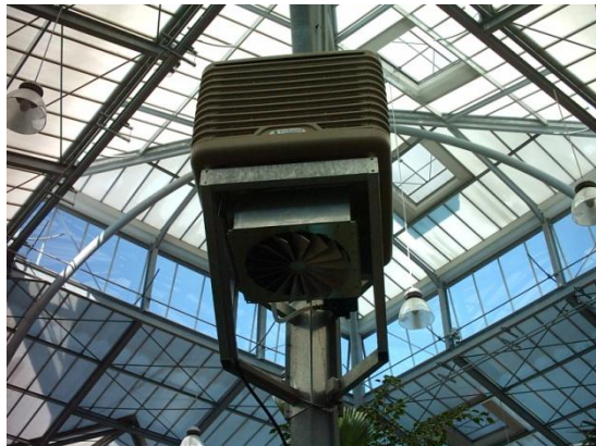
Accroché à la structure du bâtiment
