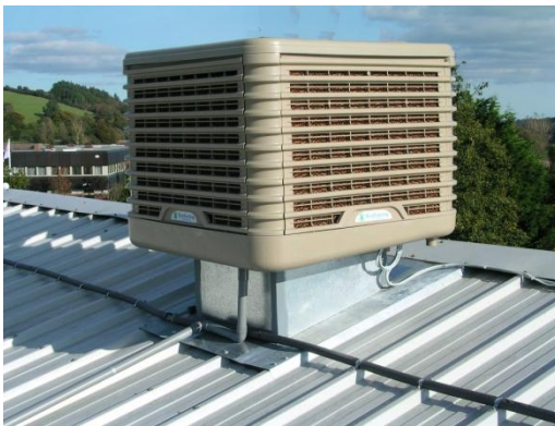
En toiture, soufflage vers le bas
