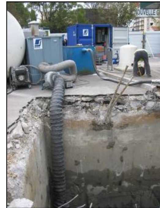
Extraction des gaz explosifs en fond de fouille et traitement de ces derniers sur filtre charbon actif
