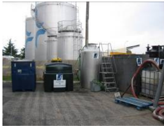
Traitement primaire des eaux souterraines
