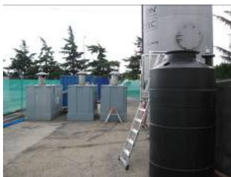
Traitement des gaz extraits sur 3 filtres charbon actif
